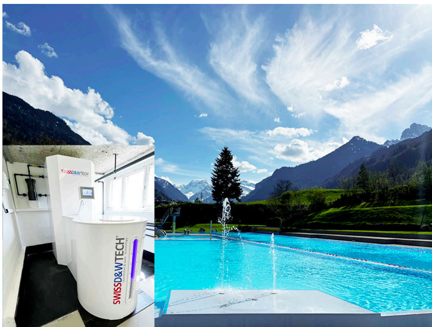
SWISS D&W TECH-Elektrolyseanlage im Freibad Wyden.
