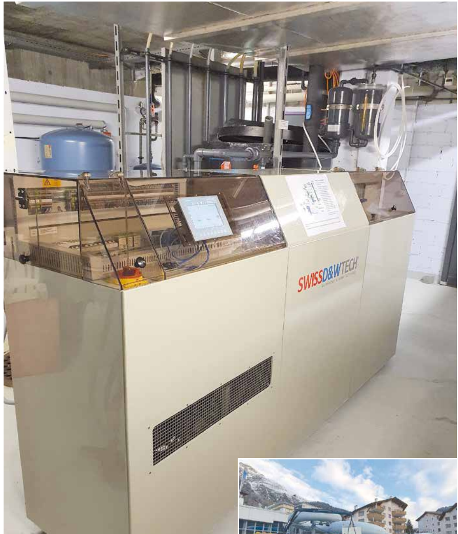
Foto oben: Nachhaltige Modernisierung von Elektrolyseanlagen.
