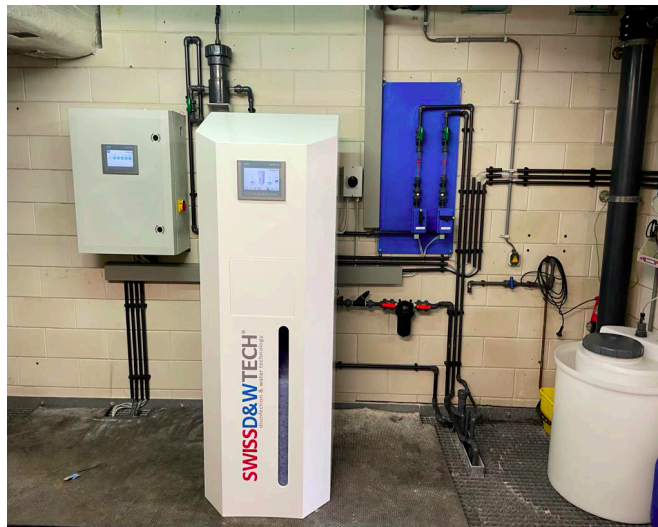
SWISS D&W TECH Anlage mit Steuerung, Zellenreinigung mittels Schwefelsäure und Stapeltank.
